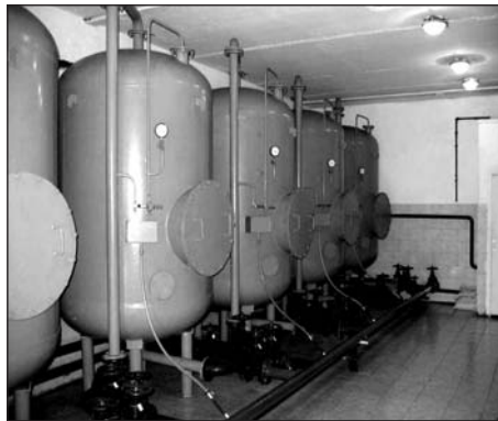
Рисунок 14 – Фильтры трех ступеней очистки очистного сооружения индивидуального проектирования
