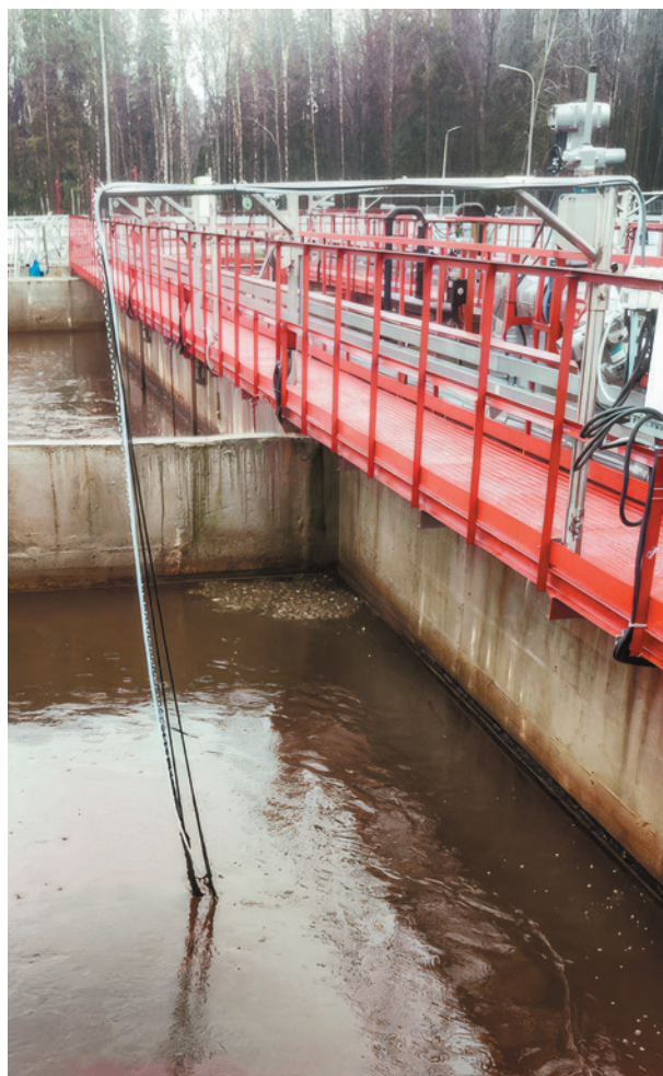
Резервуар очистных сооружений с установленной мешалкой AIKON QJB2
